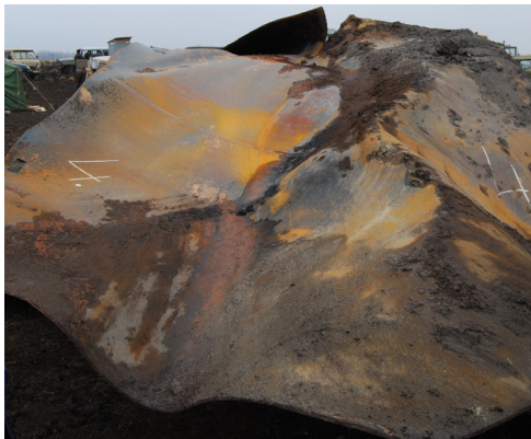
Рис. 1. Руйнування магістрального газопроводу
